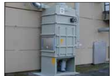
Berstscheibe zur Explosionsdruckentlastung im Freien
